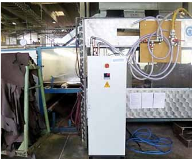
Installation einer Flachbeschichtungsanlage
